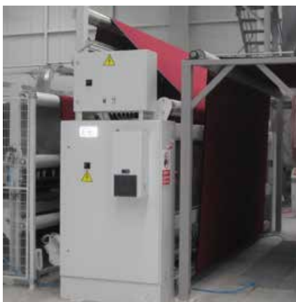
ELSTRAIGHT HD in einer Teppichanlage
